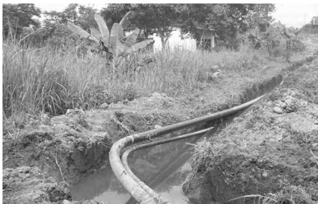
Figura 10.1. Impactos del extractivismo petrolero en la Amazonia ecuatoriana. Ductos plásticos, en malas condiciones, tendidos en la localidad de Lago Agrio (provincia Sucumbíos), conectando pozos con centros de bombeo y reconducción. Las repetidas roturas generan contaminación de suelos y aguas. Fotografía del autor.
